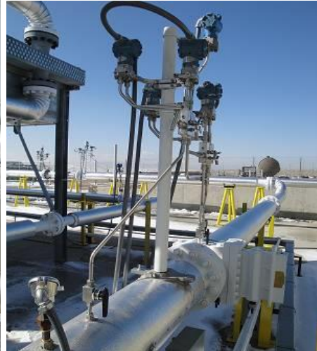
Fig 26. CEESI 8" 0.564β Orifice Meter
